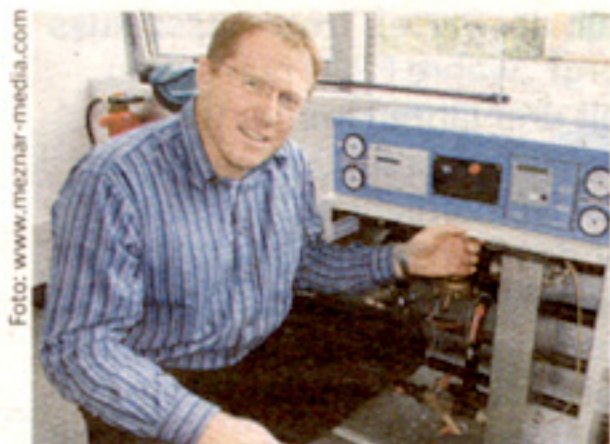
Heizkraftwerk-Geschäftsführer Karl Resch bei der Wärmeübergabestation, die bei jedem Kunden aufgestellt wird.
