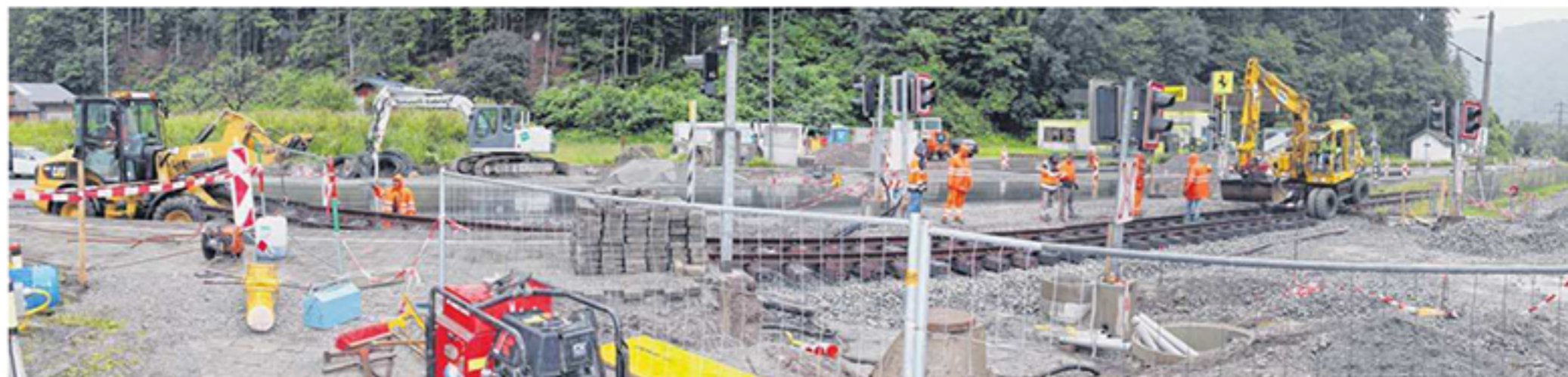
Im Zuge der Umbauarbeiten bei der L188-Kreuzung wurde auch die Trasse der Montafonerbahn erneuert.
