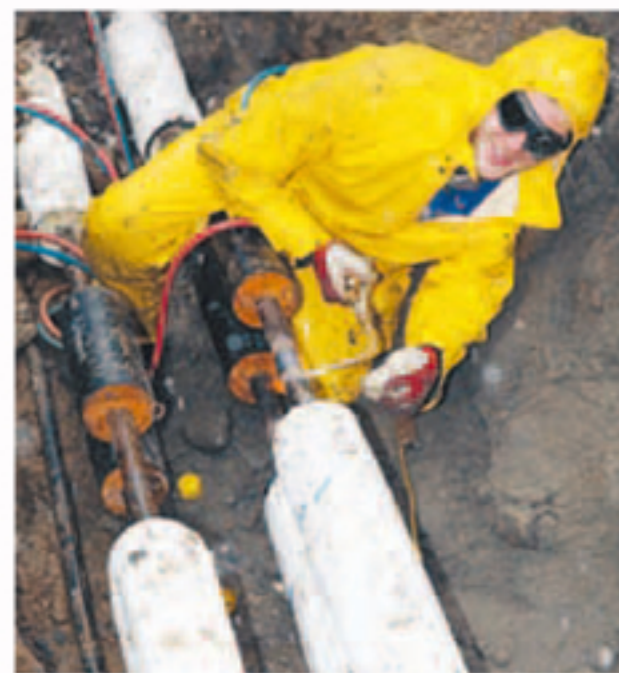
Bei der Verlegung der Fernwärme-Leitungen für die Busgarage wurde erstmals das Rohrfrost-Verfahren angewendet.
